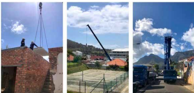
Auf der Baustelle in Kapstadt zu Beginn eines Bauprojekts Quelle: Karla Kubica | MedienLabor
